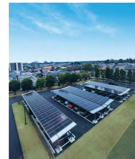
東部創薬研究所に設置された太陽光パネル
