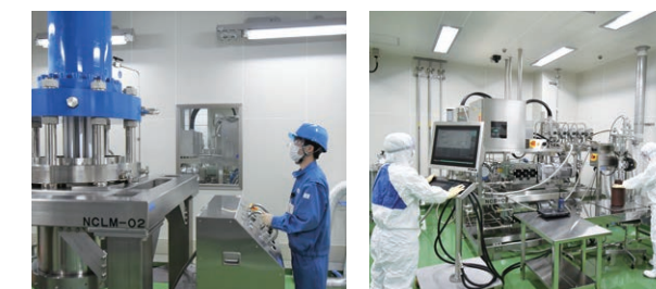
核酸原薬精製棟クロマトシステム
